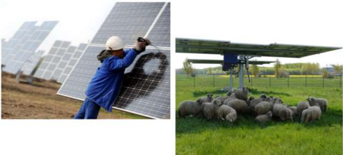
5. ábra. 400 kWp teljesítményű, hálózatra kapcsolódó fotovoltaikus rendszer Újszilváson
